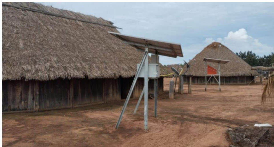
Fotografia 3: Instalação do Sistema Individual de Geração com Fonte Intermitente (SIGFI) na Aldeia Khikatxi
