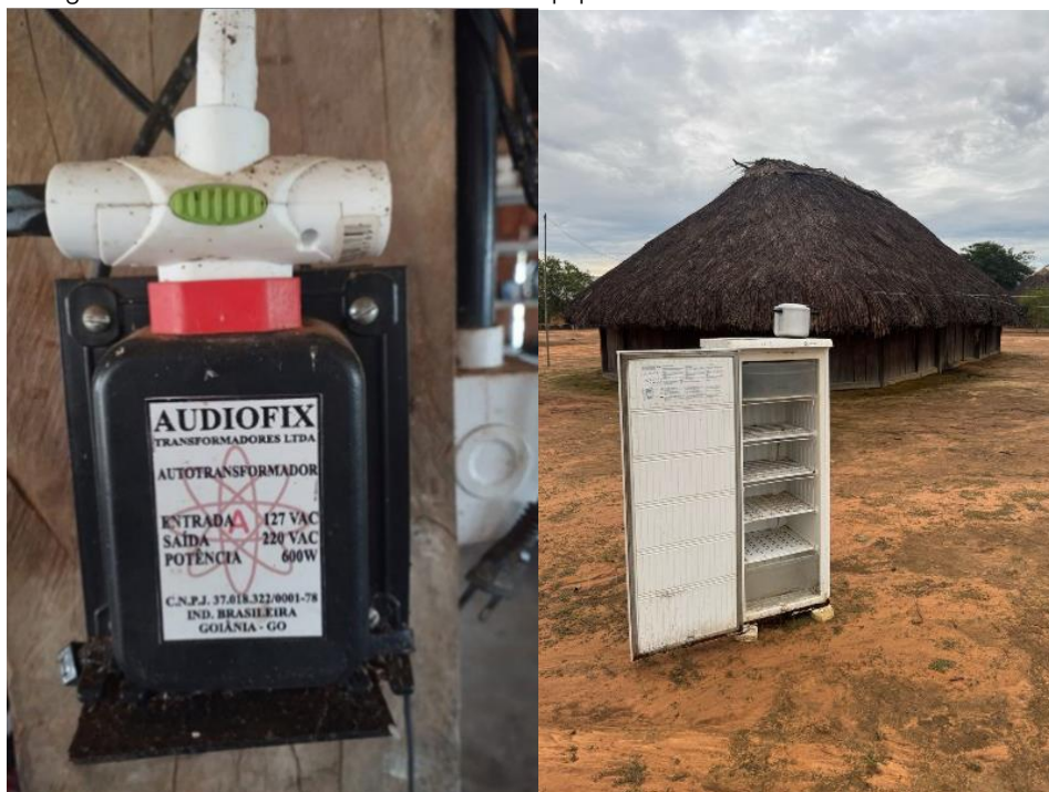
Fotografia 2: Transformador 127/220V e equipamento danificado na Aldeia Khikatxi
