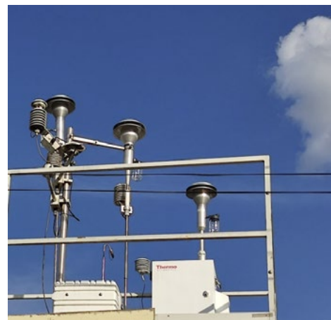
Detalhe da estação de monitoramento da qualidade do ar.
